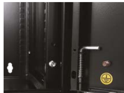
Singoli punti di messa a terra su tutta la struttura.
